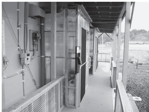
玄関前ポーチ：結露で引き戸が凍り、工事前はお湯で溶かして出入りしていたとのこと。（時には窓から出入りしたと…）
