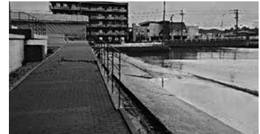
地割れが起き、岸壁が洗んでしまっている
